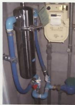
マンションへの設置例
